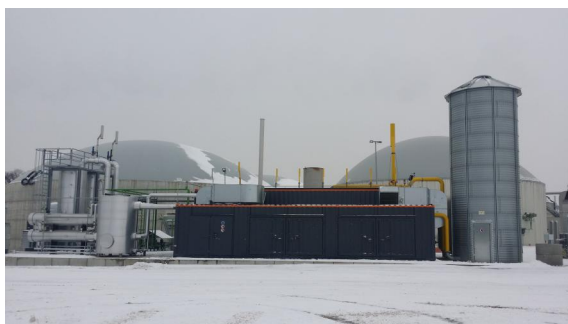
Centrale biométhane GASEO-ETW à Nonnendorf (D)
