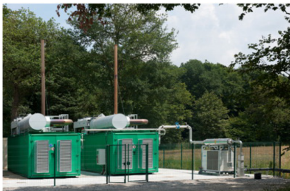
Centrale de cogénération biogaz GASEO à Chézy (03)
