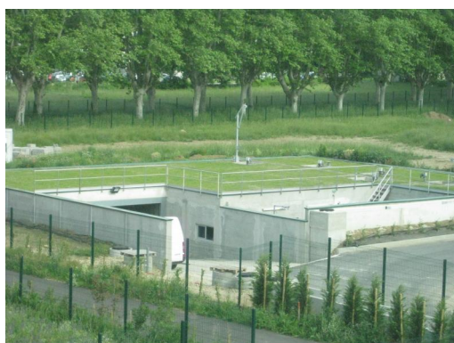
STATION DE TRAITEMENT DES EAUX USÉES CLÉ EN MAIN RÉALISÉE POUR LA SOCIÉTÉ NATUREX ET ENTERRÉE À -7M
